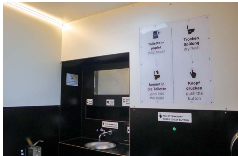
Abbildung 3: Das Modell Autark+Modular von EcoToiletten – Innenansicht (Bild: EcoToiletten GmbH)
